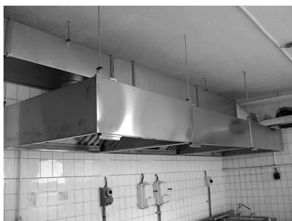
Nová vzduchotechnika v jedálni ZŠ Šaštín-Stráže
